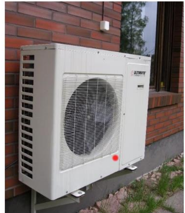
Außeneinheit einer Luft-Wasser-Wärmepumpe
